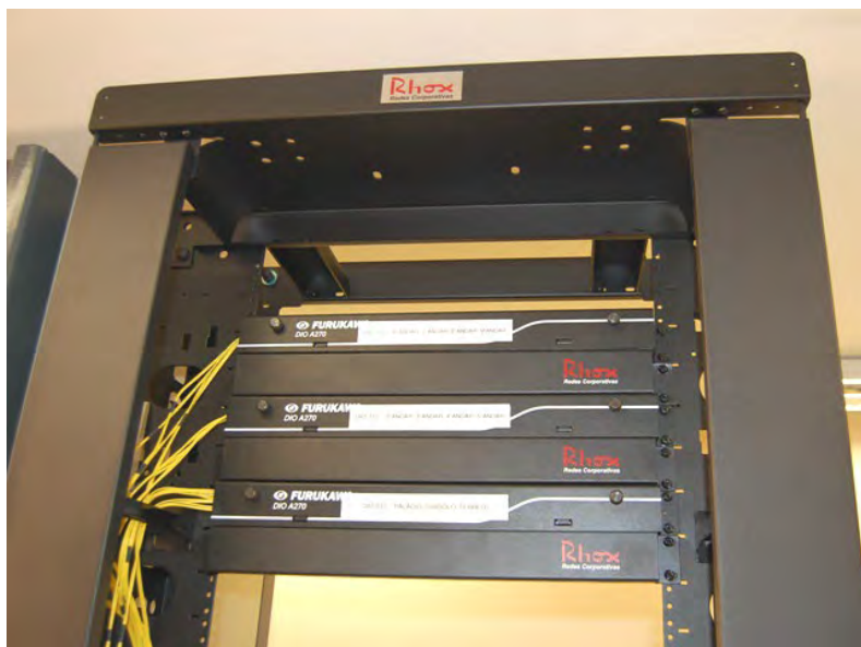
Fig. 7.8: Rack DGT e os distribuidores ópticos
