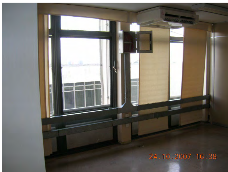
Fig. 4.5: Eletrocalhas junto às janelas
