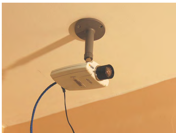
Fig. 7.21: Câmera IP instalada
