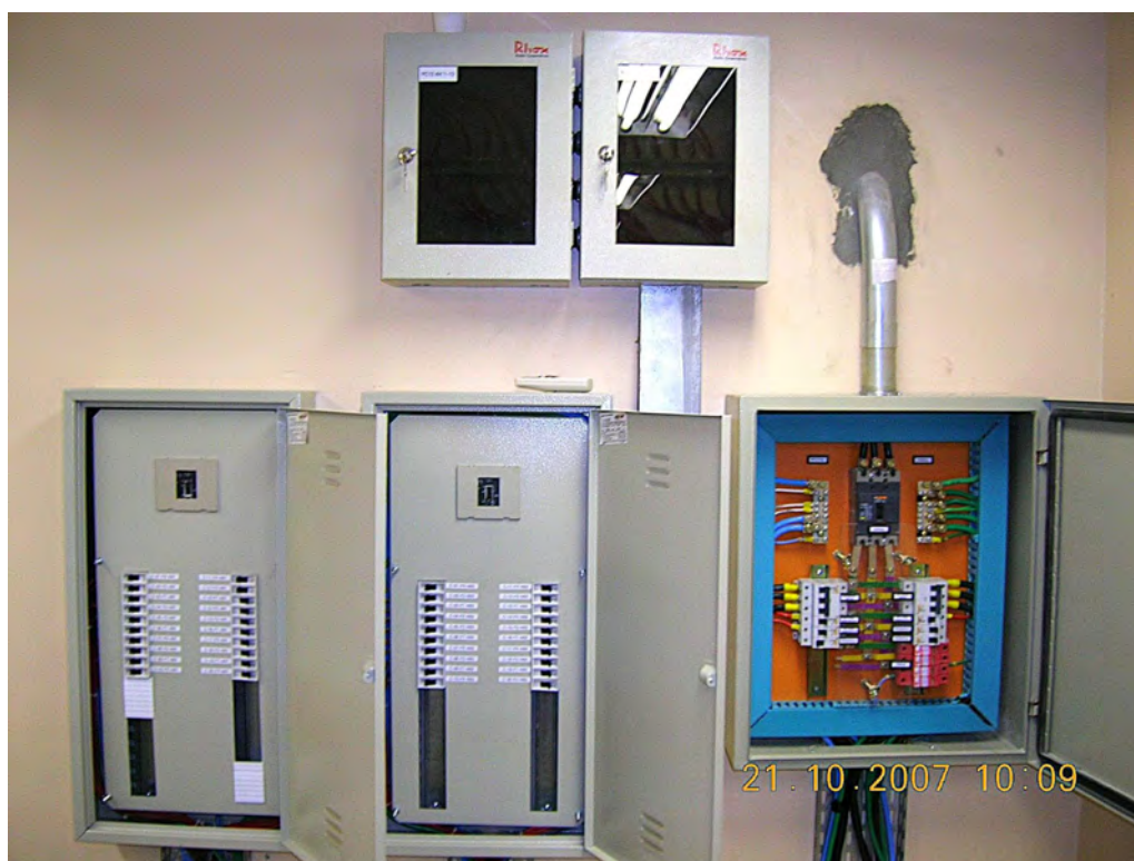
Fig. 6.2: Quadros elétricos do CPD
