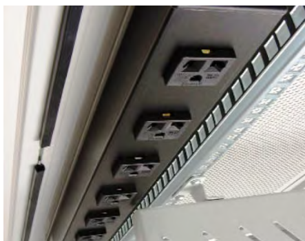
Fig. 4.18: Calha de tomadas
