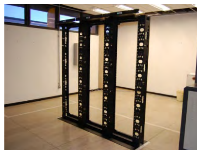
Fig. 1.2: Racks Abertos especificados no projeto
