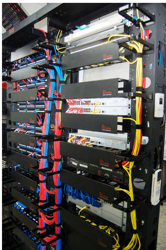
Fig. 4.6: Sala ER – racks – vista frontal
