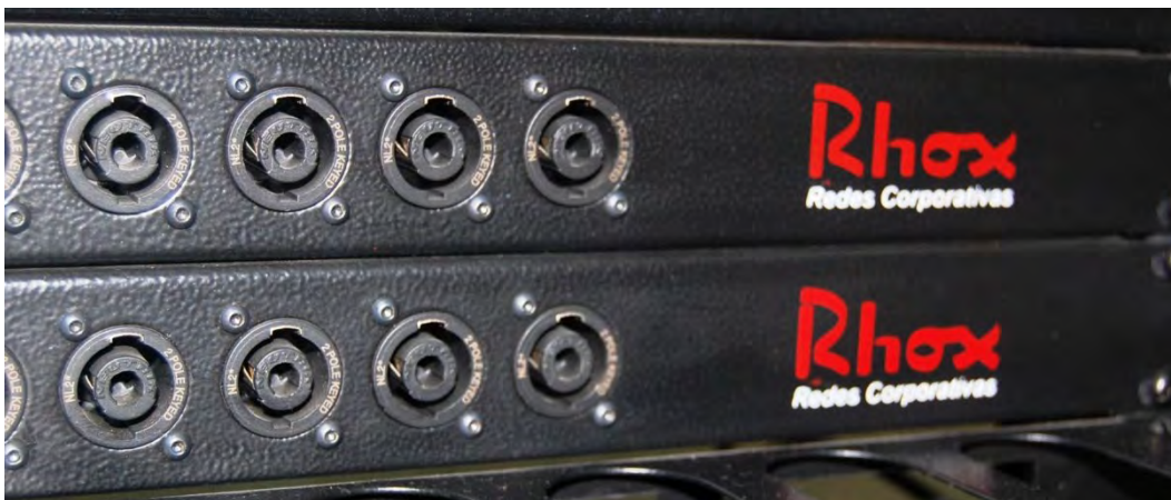
Fig 5.17: painéis de manobra das linhas de sonorização
