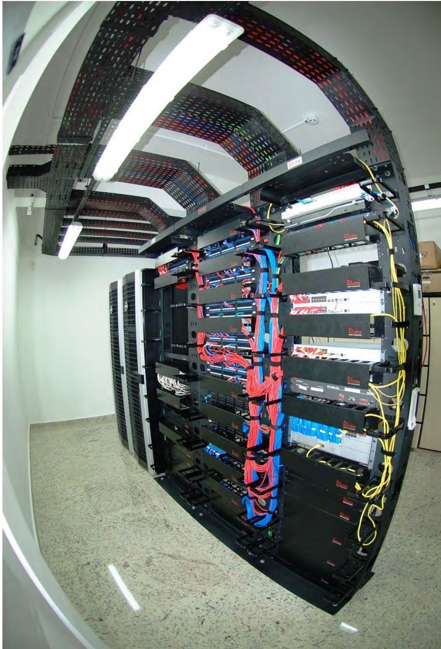
Fig. 4.20: racks da sala ER após a instalação
