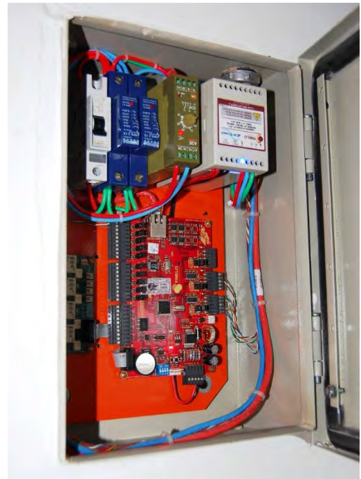
Fig. 5.21: quadro de automação
