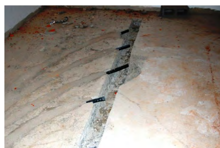
Fig. 4.8: Sala ER – rasgo no piso
