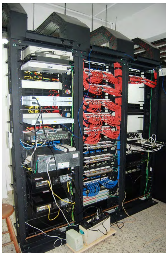
Fig. 4.7: Sala ER – racks - vista traseira
